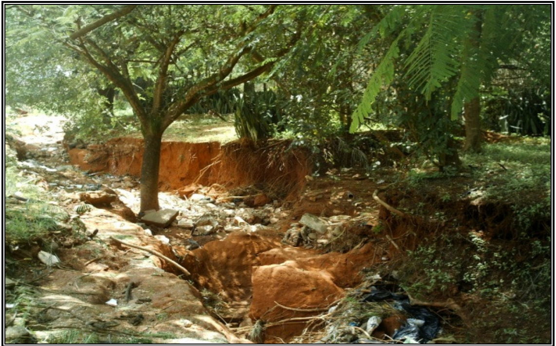
Figura 04: Erosão por falta de rede pluviais-Rua 10 em Vicente Pires. Fonte: foto do autor, Janeiro/2010.
